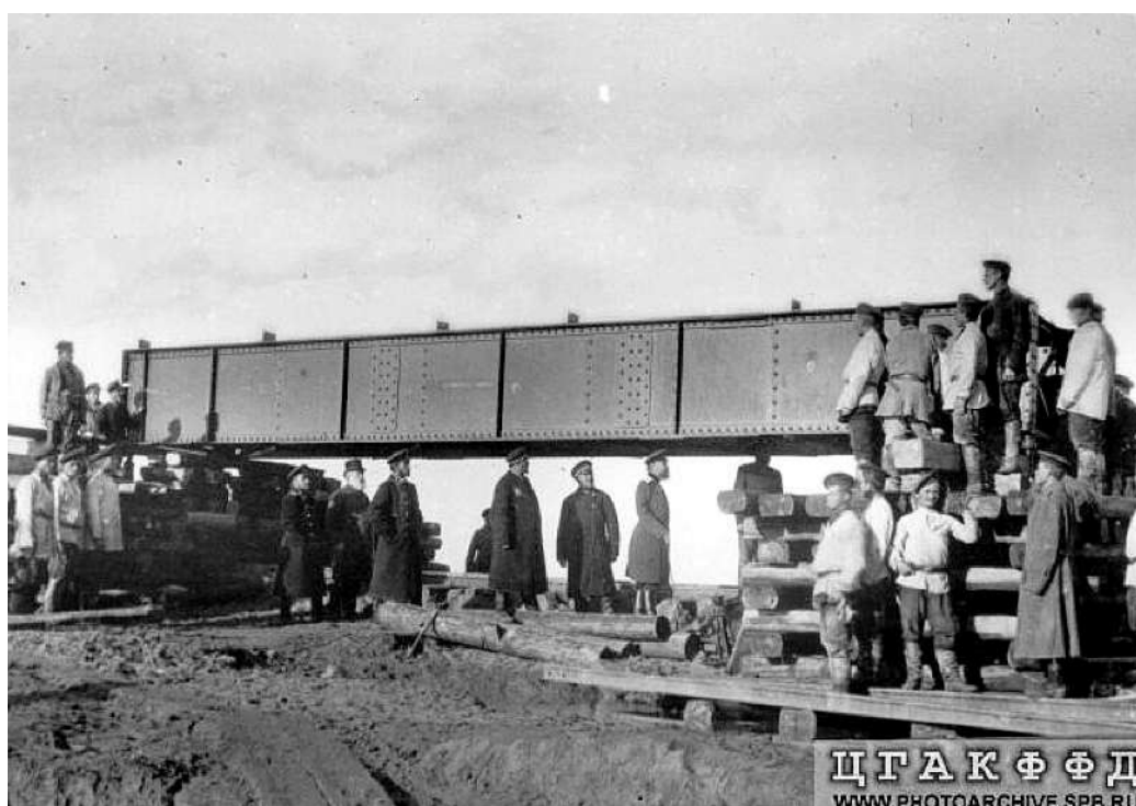
Илл. 33. Инженеры и рабочие готовят мостовую ферму к установке на опоры 1895-98. ЦГА КФФД
